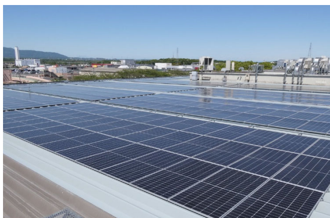
本社工場屋上 太陽光発電
